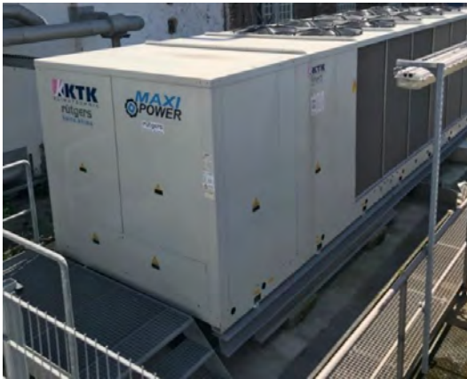
電気式冷却設備
