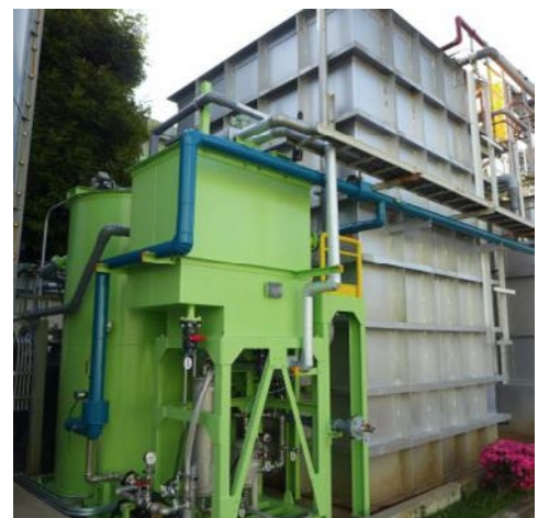
新設した加圧浮上槽（手前）
