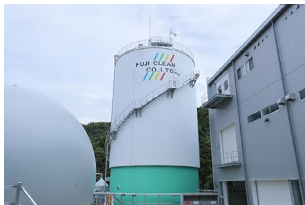
乾式メタン発酵施設
