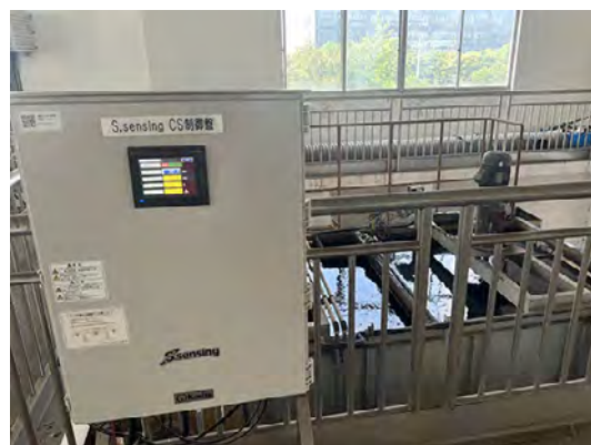
水処理薬品の自動制御システム
