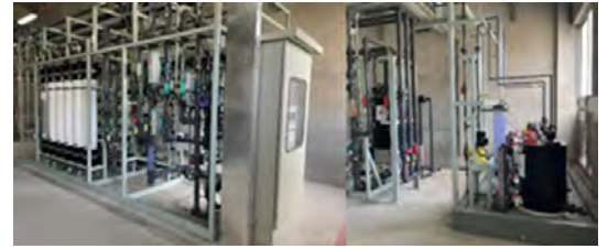
冷却塔ブロー水の回収設備
