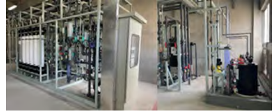
冷却塔ブロー水の回収設備
