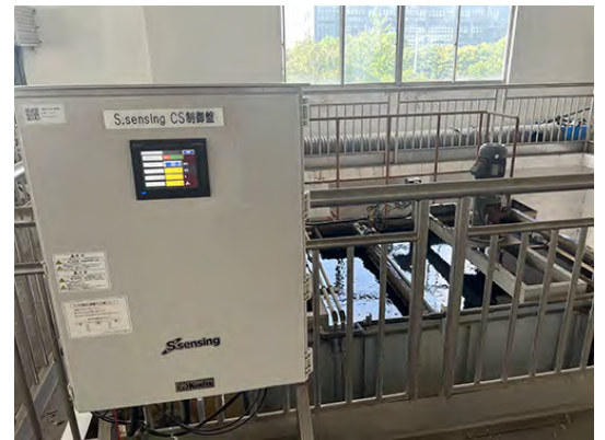
水処理薬品の自動制御システム
